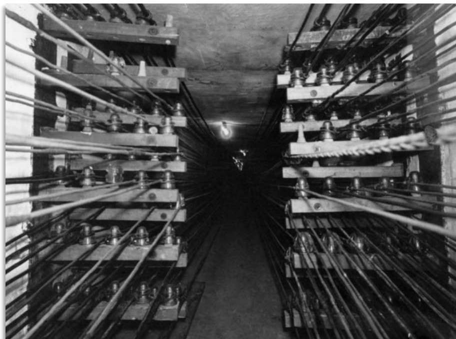
Imagem 4 – Fotografia das instalações elétricas subterrâneas da Exposição de Chicago. A opção inusitada de fotografar a rede elétrica se justifica pelo emprego da nova tecnologia e como uma forma de demonstrar o potencial industrial dos Estados Unidos. Fotografia de C. D. Arnold em platinotipia (coleção World's Columbian Exposition Photographs do Art Institute of Chicago).
